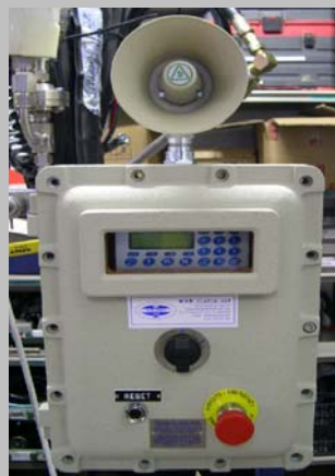
Quadro di gestione macchina Software dedicato
